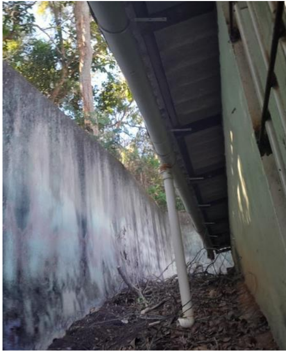
Foto 5: Ex. das calhas a receberem limpeza.
