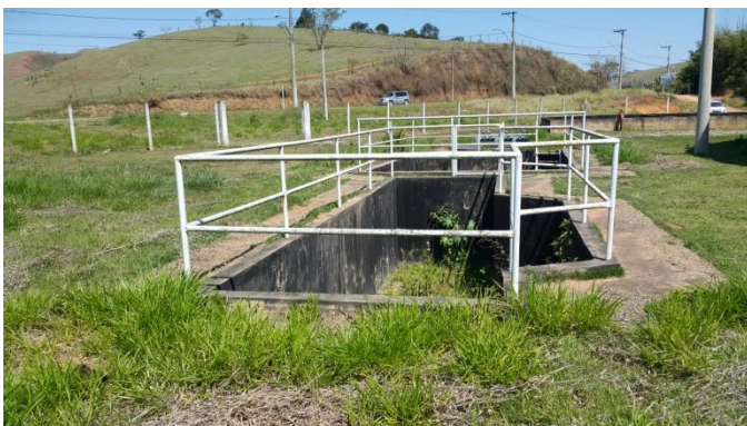
Foto 09 – Necessidade, de limpeza do fundo, tratamento/impermeabilização das paredes internas e instalação das estruturas internas do pré-tratamento, conforme projeto. Além de execução de tratamento e pintura dos guarda-corpos.
