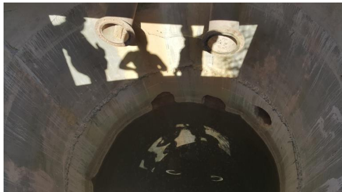
Foto 38 – Necessidade de tratamento e impermeabilização das paredes internas da Elevatória, instalação de bombas e seus acessórios, conforme projeto.
