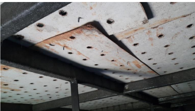
Foto 15 – Necessidade de refixação das placas de fibra nos biofiltros.
