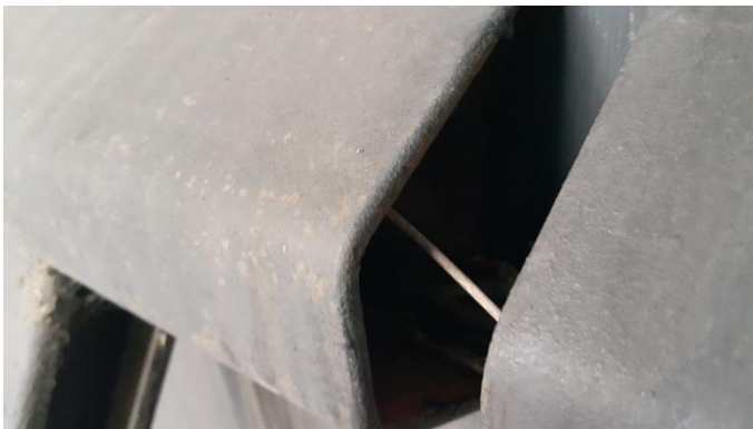
Foto 19 – Necessária complementação dos reforços de travamento das chapas de aço, tratamento anticorrosivo e soldagem das imperfeições encontradas ao longo de toda a superfície interna da Estação.
