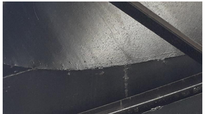
Foto 20 – Necessária complementação dos perfis de travamento das chapas de aço, tratamento anticorrosivo e soldagem das imperfeições encontradas ao longo de toda a superfície interna da Estação.
