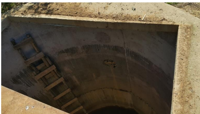
Foto 39 – Necessária instalação de tubulação de chegada na elevatória.
