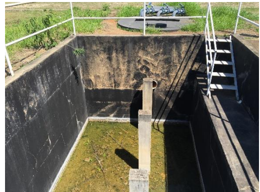
Foto 08 – Necessidade de instalação de portão para acesso à caixa de gordura.
