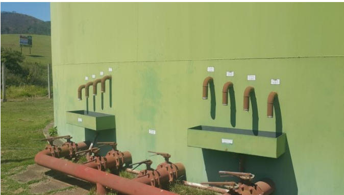
Foto 23 – Necessário troca de válvulas no barrilete de descarte de lodo e instalação de pontas de inox para tubulações de amostragem.
