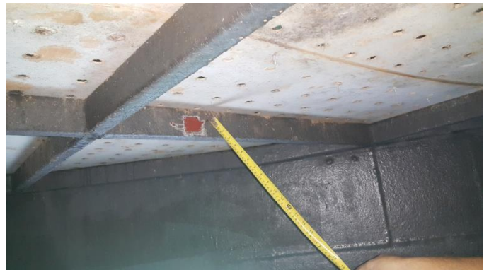
Foto 12 – Necessidade de trocas dos perfis por tubos retangulares, os perfis instalados não suportam a pressão e oxidam facilmente, sem contar com a péssima qualidade nas soldas e laminação dos mesmos.
