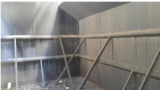
Foto 21 – Necessária complementação dos perfis de travamento das chapas de aço, tratamento anticorrosivo e soldagem das imperfeições encontradas ao longo de toda a superfície interna da Estação.
