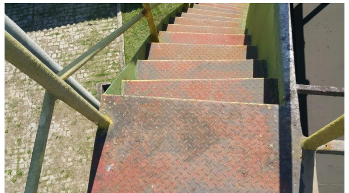
Foto 28 – Necessária regularização de degraus da escada de acesso a parte superior da Estação.
