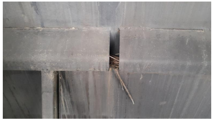
Foto 18 – Necessária complementação dos perfis de travamento das divisórias, tratamento anticorrosivo e soldagem das imperfeições encontradas ao longo de toda a superfície interna da Estação.
