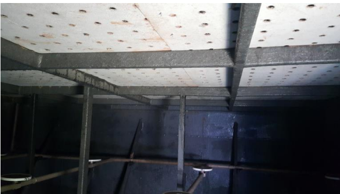
Foto 13 – Necessidade de trocas dos perfis devido a má qualidade nas solda, laminação e resistência dos mesmos.
