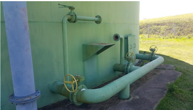
Foto 11 – Necessário manutenção ou troca das válvulas no barrilete do sistema de Nitrificação e instalação de bombas.
