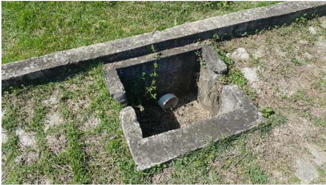
Foto 05 – Falta tampa de concreto para caixa de inspeção.
