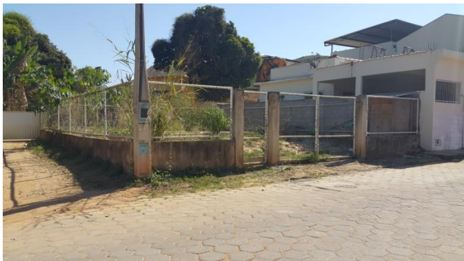
Foto 37 – Necessário pintura de muros, portão e alambrado, regularização do terreno, urbanização e execução das instalações elétricas.
