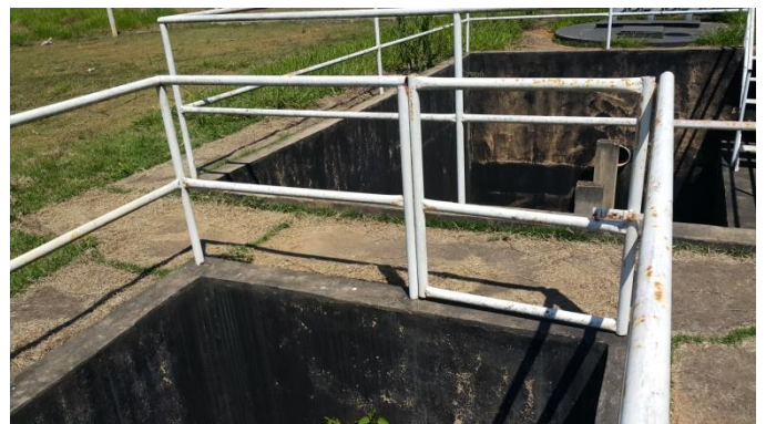
Foto 10 – Necessidade de alteração da localização de portão e construção de escada de acesso à caixa de areia. Portão construído sobre a saída do efluente, impossibilitando qualquer acesso.
