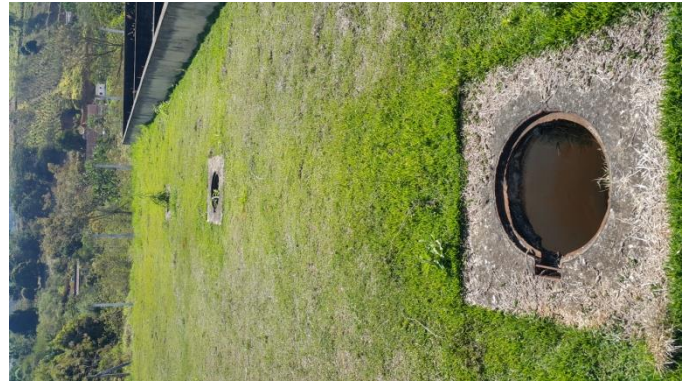
Foto 06 – Faltam tampões de esgoto em ferro fundido.
