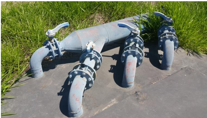
Foto 07 – Necessário manutenção e avaliação das válvulas no barrilete da Elevatória da ETE, e tratamento anticorrosivo nas paredes internas da mesma.
