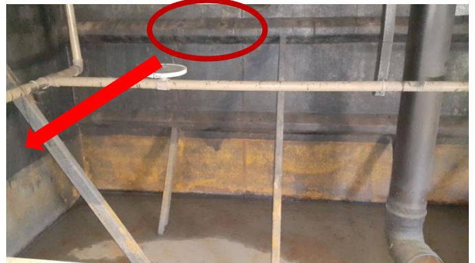
Foto 14 – Necessidade da utilização de perfis transversais para travamento das chapas de aço, além de tratamento das mesmas.
