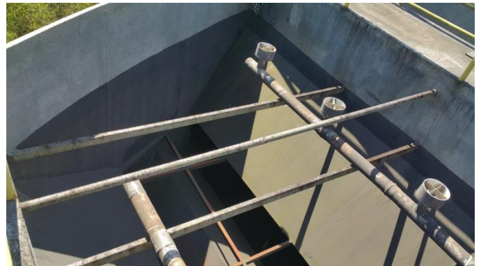
Foto 24 – Necessária instalação de braçadeiras inox nas tulipas do UASB e troca da tubulação de captação do biogás/instalação do queimador.
