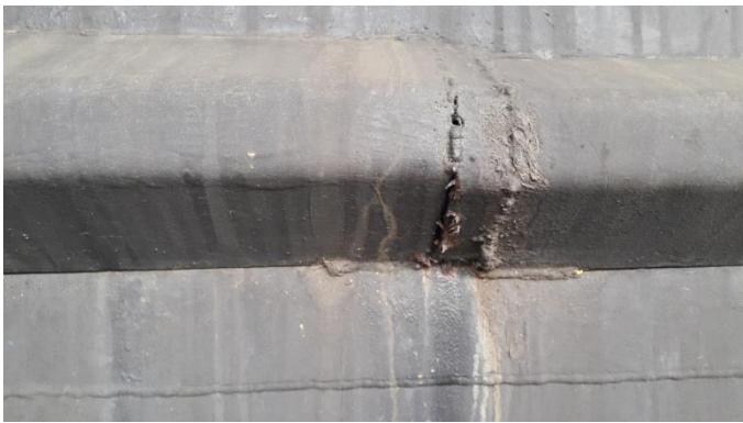
Foto 17 – Necessária complementação dos perfis de travamento das chapas de aço, tratamento anticorrosivo das paredes internas e soldagem das imperfeições encontradas ao longo de toda a superfície interna da Estação.
