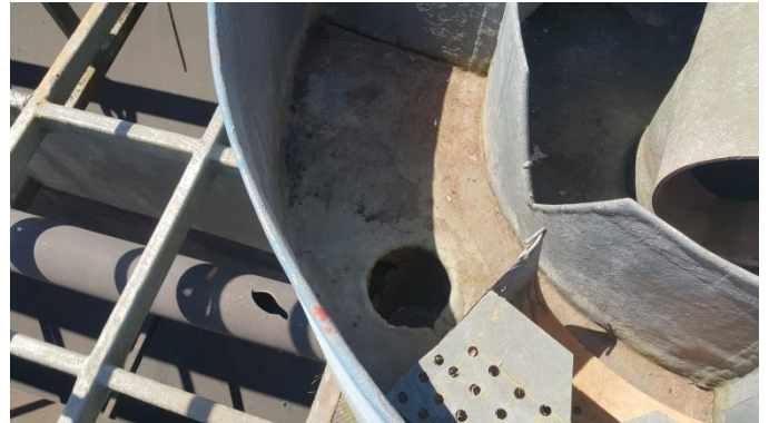
Foto 30 – Necessária recuperação da caixa de distribuição de chegada na Estação e troca de tubos de PVC danificados.
