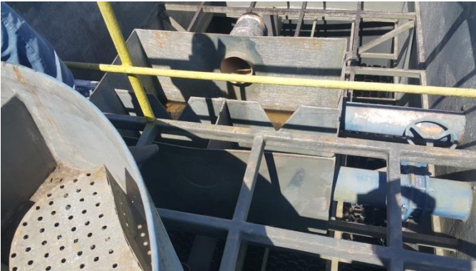
Foto 29 – Falta tampa de fibra para caixa de chegada.
