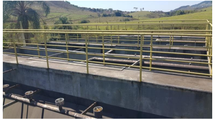
Foto 26 – Necessidade de tratamento e pintura dos guarda-corpos da parte superior da Estação e da escada de acesso.
